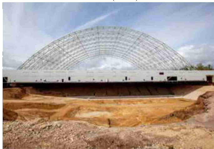
Bei der Sanierung der Deponie Bonfol (JU) wird der Sondermüll unter einer Aushubhalle ausgebaggert.
