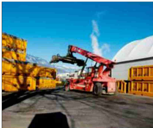
Zum Abtransport vorbereitetes Aushubmaterial in der Deponie Le Pont Rouge in Monthey (VS)
